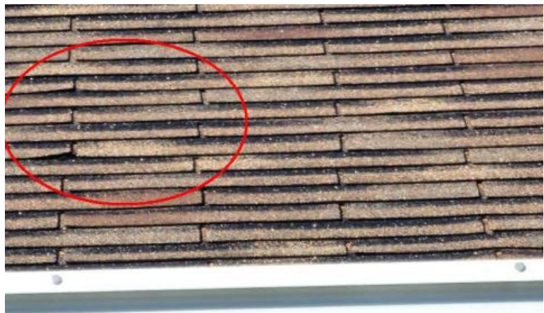
Certains bardeaux sont soulevés. Signe d'une mauvaise adhérence.
