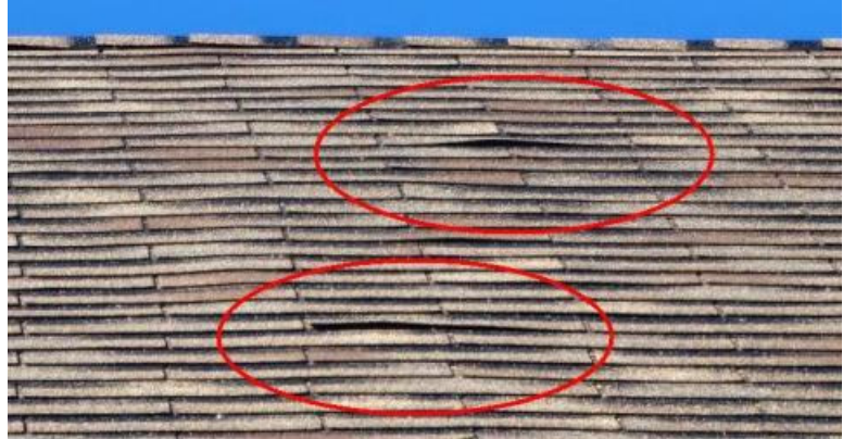
Certains bardeaux sont soulevés. Signe d'une mauvaise adhérence.
